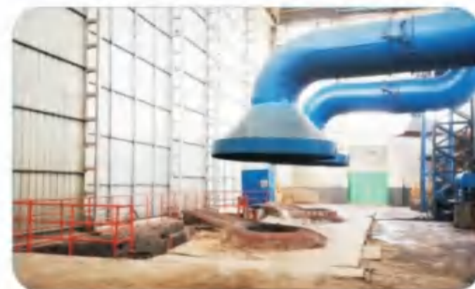
2 × 25吨电炉 25 ton electric furnace
